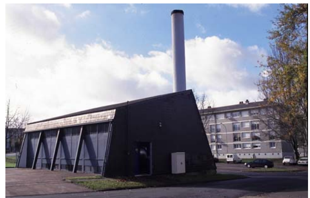
SOCLOVA à Angers (49) – 2.2 MW Source : ADEME
